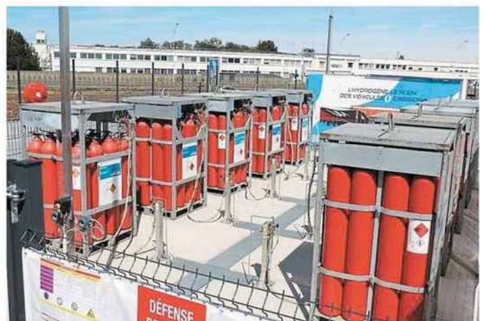
La station de stockage de l'hydrogène.
